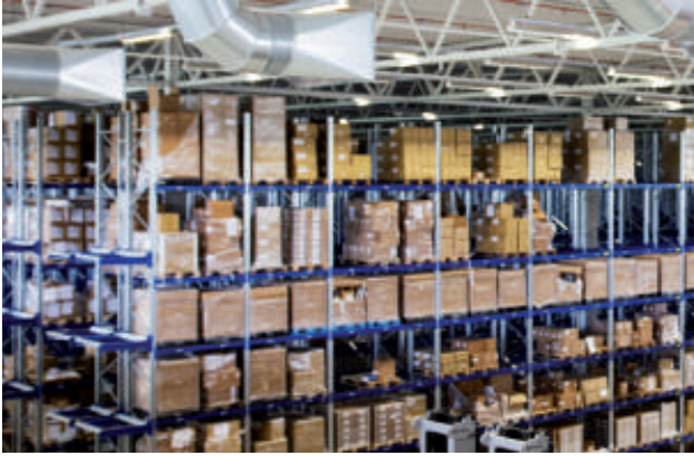
Depoya cihaz yerleşimi
