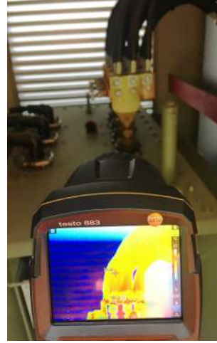
Resim 2: Alçak gerilim kablosu aracılığıyla bir transformatörün (20.000 volt ila 400 volt) bağlantısının termografik görüntüsü.
